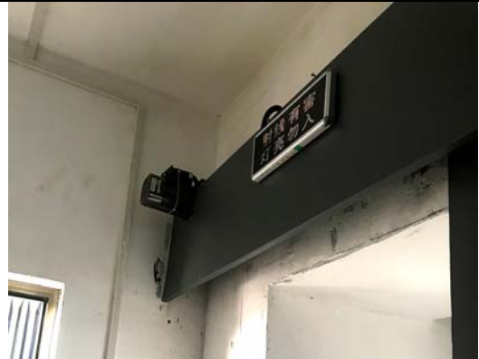
探伤室东侧（小防护门外）工作状态指示灯
