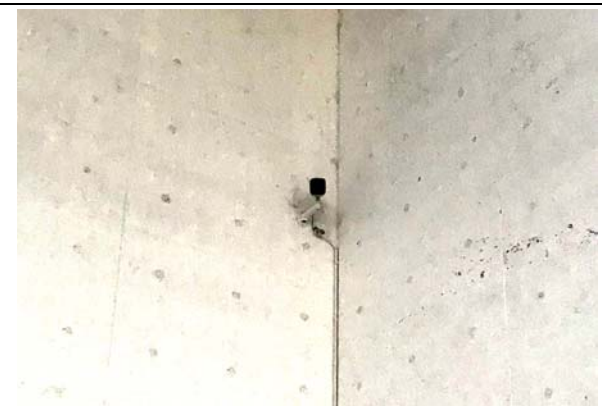
探伤室内东南侧防护面顶部监控设备
