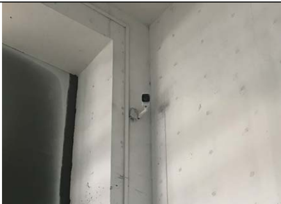
探伤室内西北侧防护面顶部监控设备
