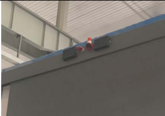
探伤室西侧（大防护门外）工作状态指示灯
