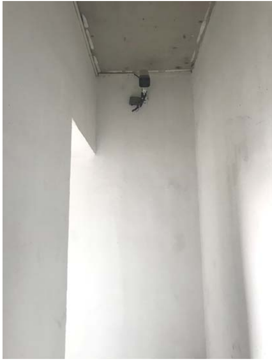
迷道内监控设备
